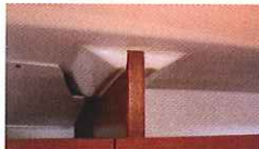
L'incastro delle paratie in coperta, così come il controstampo in sentina, sono spesso poco rifiniti o troppo visibili
